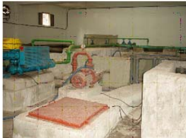
EDAR de colegio Heidelberg, instalada en 1980. Mantenimiento realizado por la propiedad.
